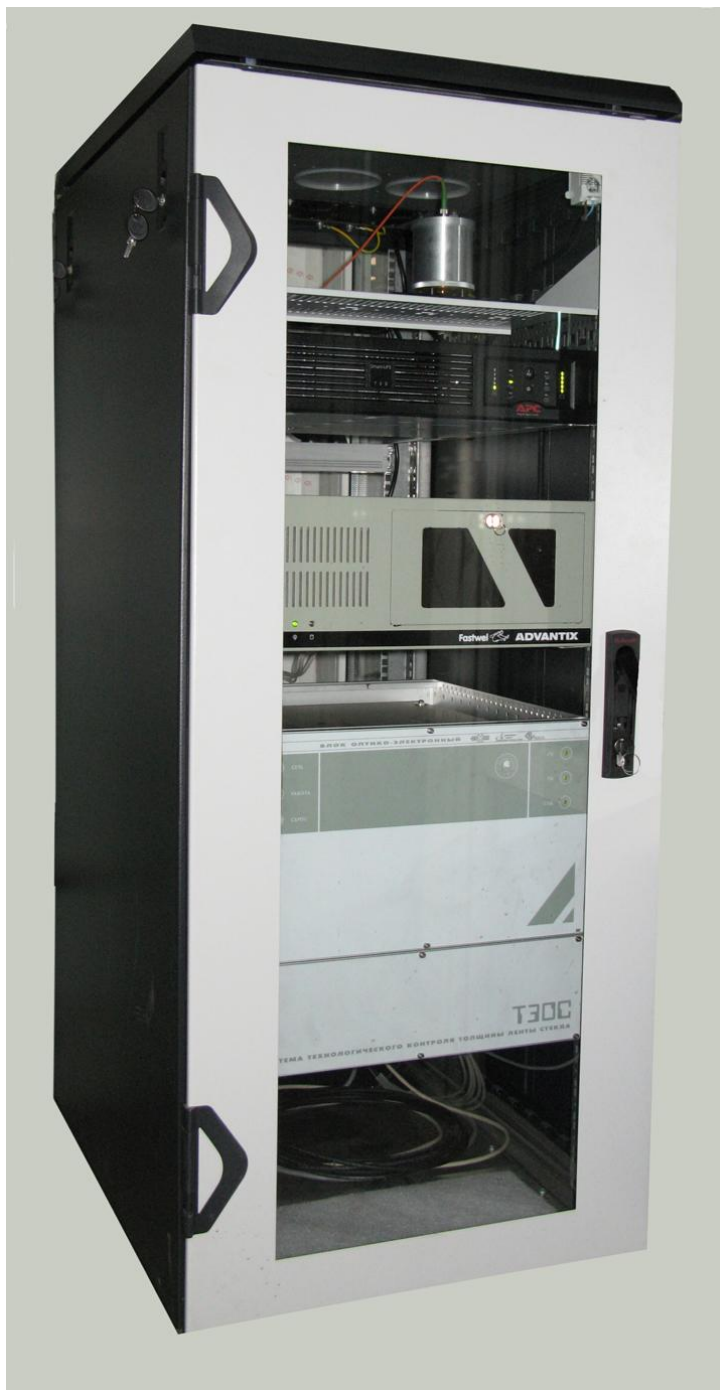
Рис. 2. Стойка 19" с установленными: блоком оптоэлектронным, промышленным компьютером, блоком бесперебойного питания, контрольной головкой.
