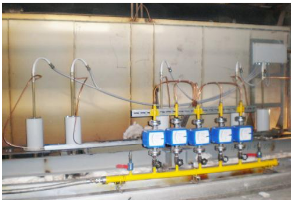
Рис. 4. Оптические головки, установленные за шлаковой камерой (5 вал печи отжига)
